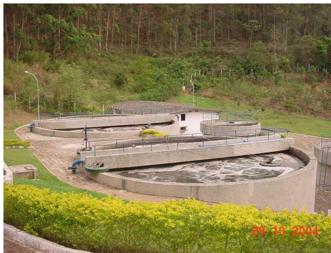
Figura 49 – Estação de tratamento de esgoto de Santa Maria de Jetibá
